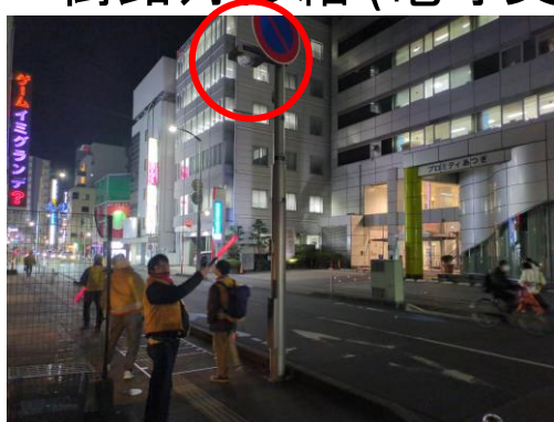
損傷個所の写真 街路灯が切れている
