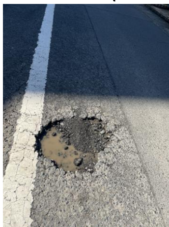
損傷個所の写真 道路(穴ぼこ)
