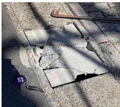
損傷個所の写真 道路(甲蓋の損傷)
