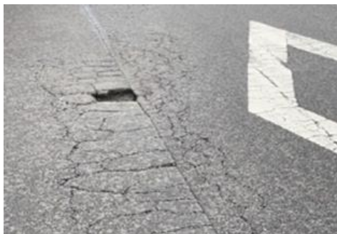
損傷個所の写真 道路(穴ぼこ)
