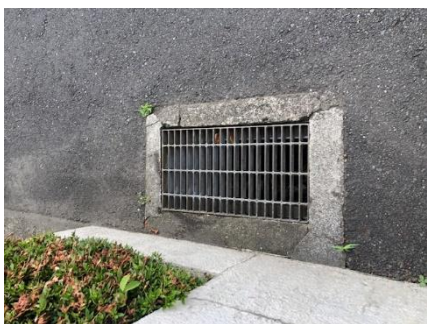
情報提供いただいた写真 道路(グレーチングの老朽化)
