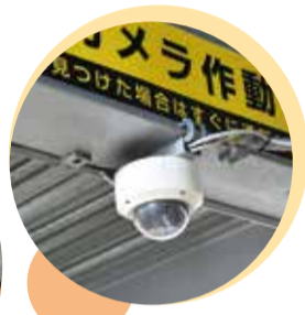
盗難防止に効果的な防犯カメラを各階に設置
