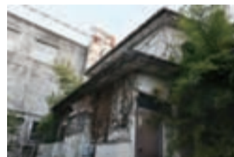
長年放置された空き家
