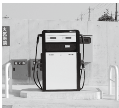
北消防署に整備された給油所
