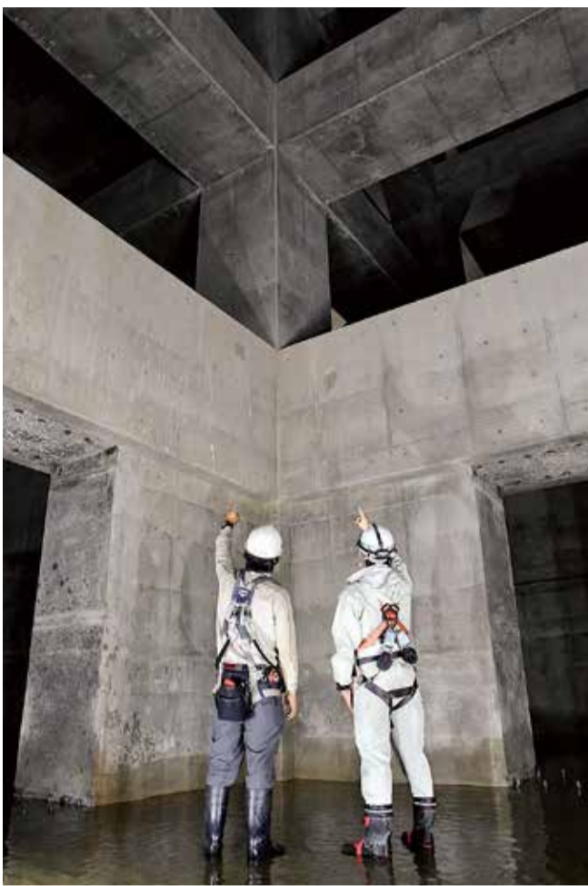
8月末に完成したあさひ公園地下の雨水貯留施設。10月の台風19号の際に効果を発揮した
