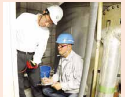
ボイラー室で省エネ効果を確認
