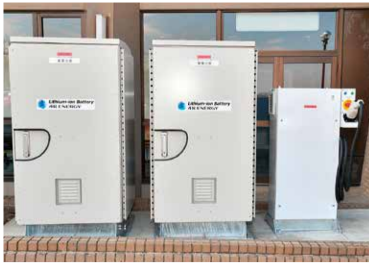
設置された蓄電池（左・中央）とパワーコンディショナー
