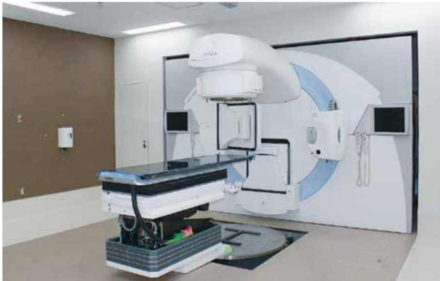
リニアック(直線加速装置)を活用した放射線治療室でがん治療を実施
