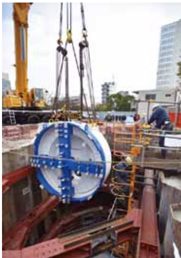
厚木排水区浸水対策北貯留管を掘削するシールド先端部
