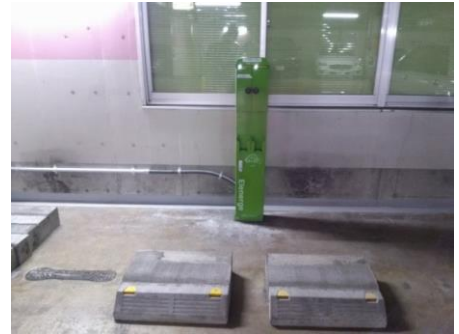
中央公園地下駐車場の普通充電器
