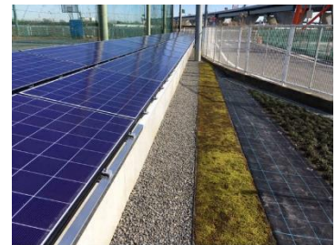
相川中学校に設置した太陽光発電
