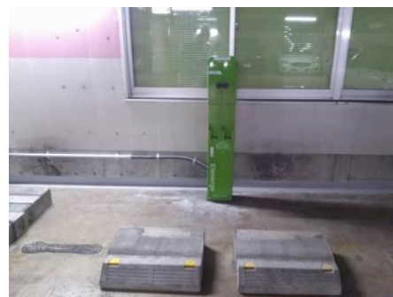
中央公園地下駐車場の普通充電器
