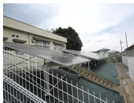
鳶尾小学校に設置した太陽光発電
