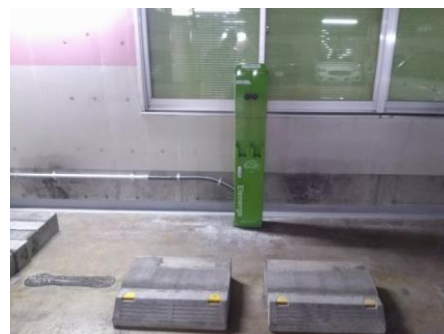
中央公園地下駐車場の普通充電器
