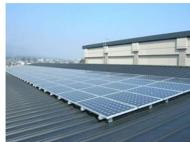
荻野公民館の太陽光発電設備
