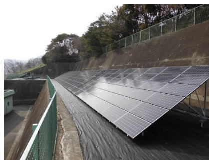
飯山小学校に設置した太陽光発電
