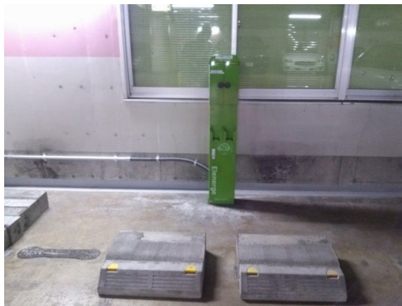
中央公園地下駐車場の普通充電器
