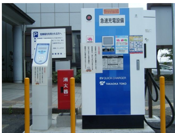
市内5箇所に急速充電器を設置
