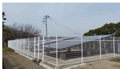
緑ヶ丘小学校に設置した太陽光発電
