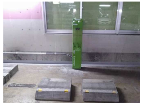
中央公園地下駐車場の普通充電器
