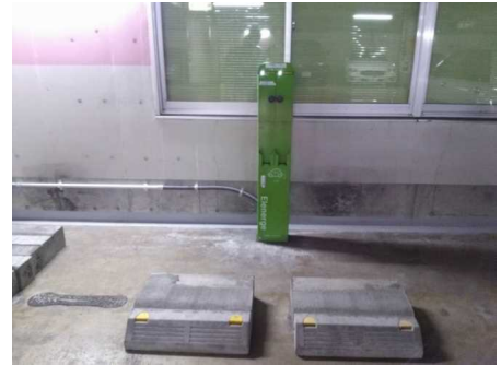
中央公園地下駐車場の普通充電器
