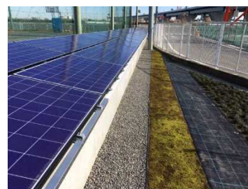
相川中学校に設置した太陽光発電
