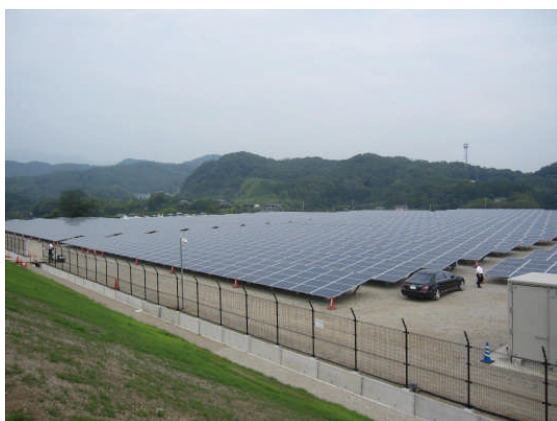
県央厚木第一発電所（第一期）
