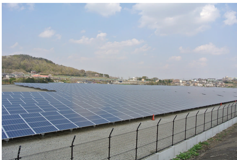
県央厚木第一発電所(第1期)
