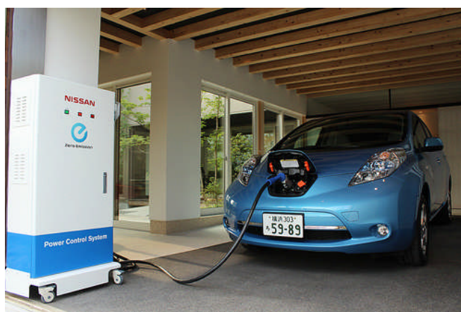
PCS(Power Control System)(画像左)
