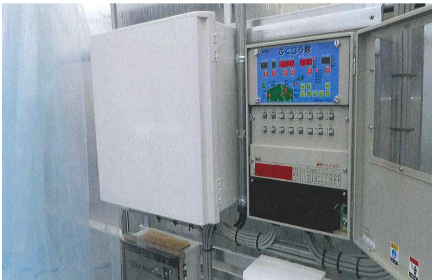
複合環境制御装置（低コスト耐候性ハウスに設置）
