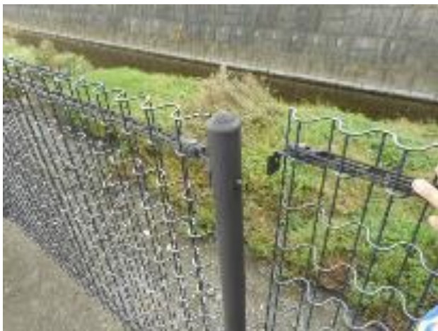
写真 3-3 巡視によって発見した転落防止策の破損状況
