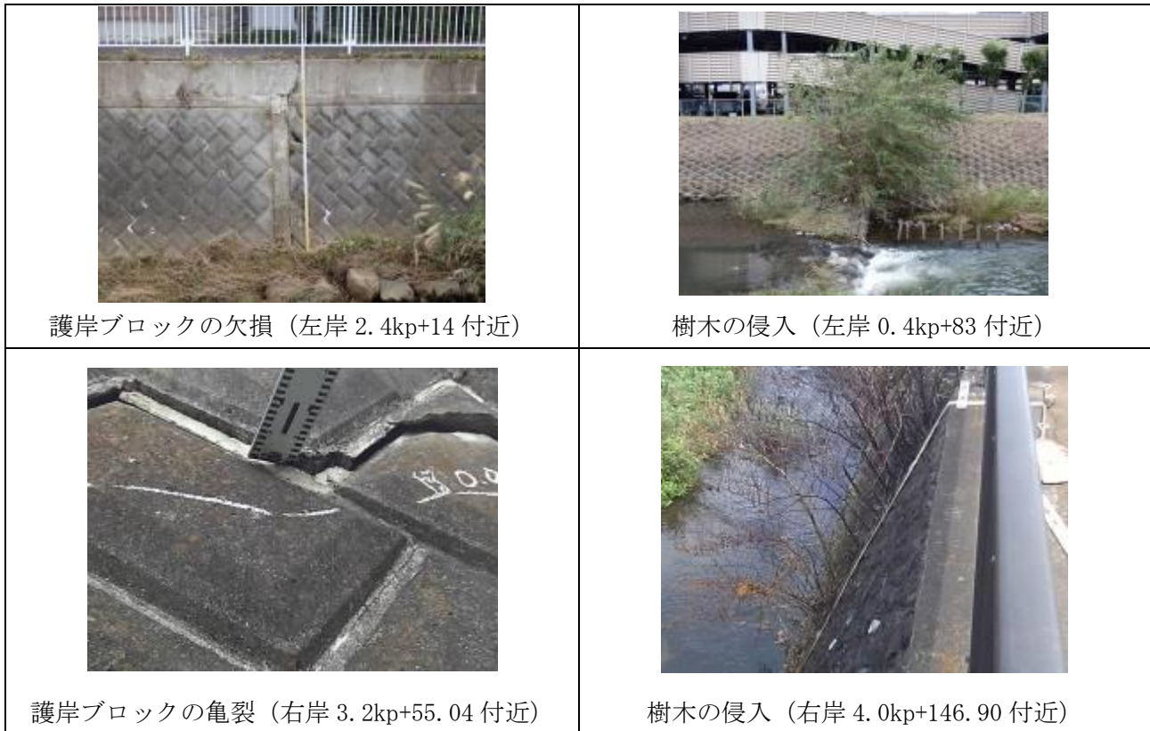
図 1-2 老朽化による護岸の変状例 (恩曾川)
