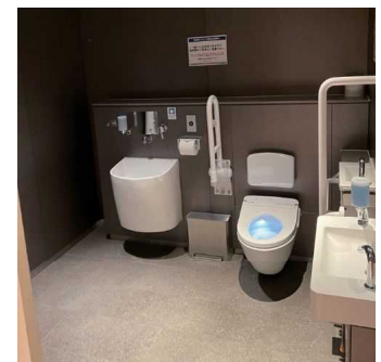
みんなのトイレ（車いす対応）
