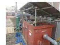
図表13 排水処理施設
