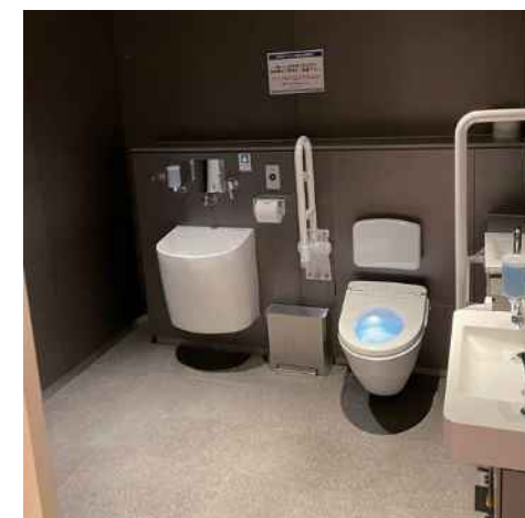
みんなのトイレ（車いす対応）
