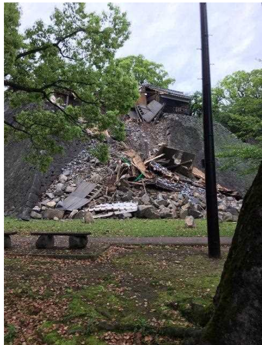
崩壊した熊本城
