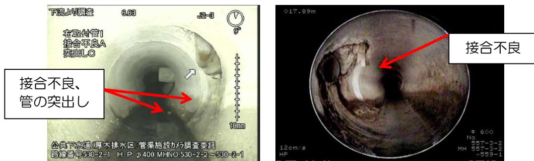
写真3-10 管きよ内の状況
