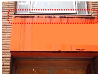
その他（塗装剥離、腐食など）
