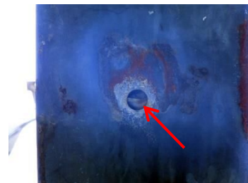
水抜き孔の詰まり
