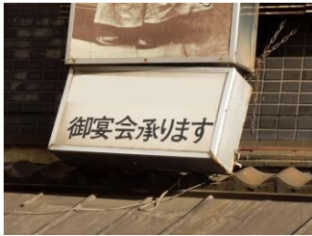
屋外広告物本体の傾き
