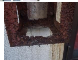
支持部が腐食していた看板の例
