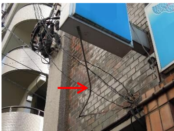
振れ止め棒が変形した状態
