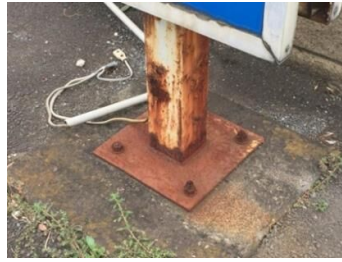
支柱根元の腐食、支柱と基礎部分・根巻きに生じた隙間、支柱ぐらつき
