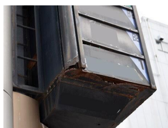
側板底面が腐食、破損した状態
