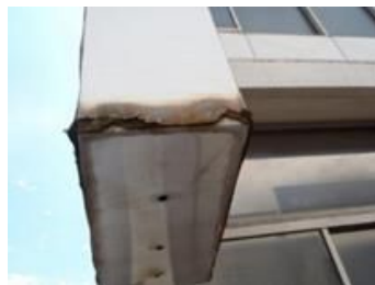
広告板底部の腐食
