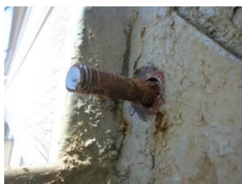
アンカーボルトのさびが進行し、ネジ山が欠損した状態
