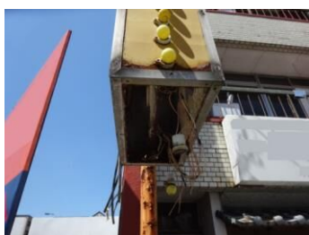
側板底面が欠損した状態
