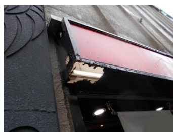
側板底面の腐食が進行した状態
