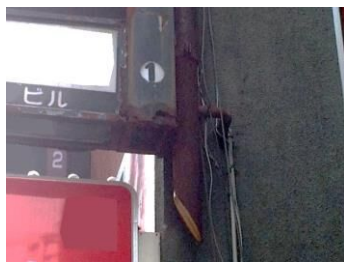
支持部が腐食した状態
