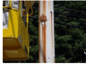
その他（支柱の腐食など）
