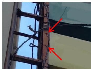
ボルトのゆるみや欠落した状態
