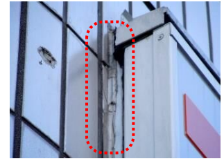
コーキングが劣化した状態
