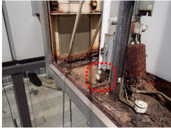
蛍光灯のホルダーが破損した状態
