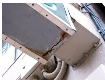
側板底面が破損した状態
