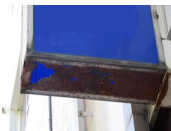
側板底面が腐食、破損した状態
