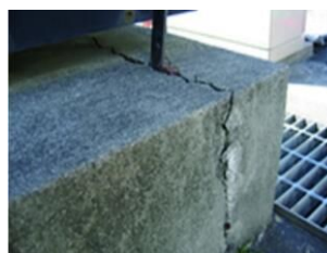
基礎にクラックが入った状態
