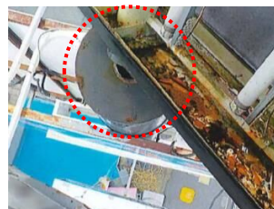
鉄骨接合部（プレート）が破損している状態
