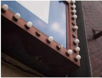
ランプ球が破損した状態
