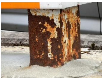
支柱根元の腐食が進行した状態
