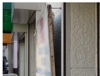
壁面との間に隙間が生じた状態
