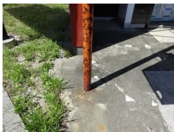
支柱の腐食が進行した状態
