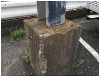
根巻きコンクリートが劣化し、欠けた状態
