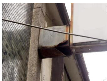
ブラケットカバーに発生したさびが進行した状態
