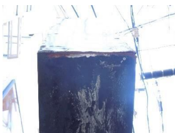
側板底面にさびが発生した状態
