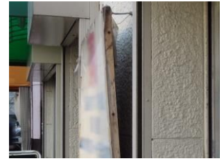
壁面との間に隙間が生じた状態
