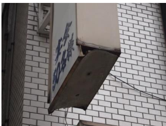
その他 (塗装剥離、腐食など)
