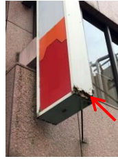
広告板底部の腐食が進行した状態
