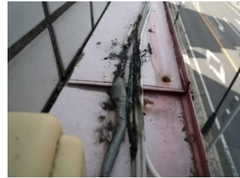
配線が劣化し、ショートした状態
