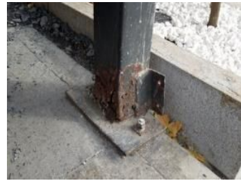
支柱根元の腐食が進行した状態
