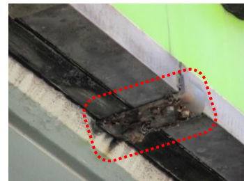
金具が劣化した状態
