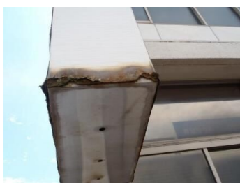
側板の腐食が進行した状態
