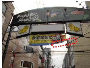
幕材を張る部材が破損した 状態
