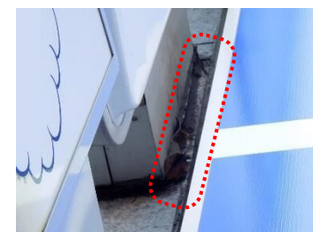
コーキングが劣化した状態
