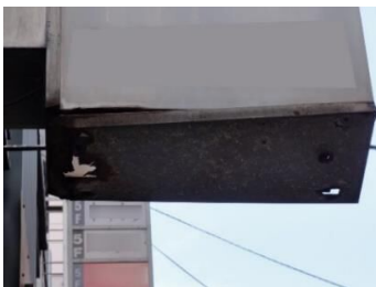
側板・表示面板押さえの変形・破損・部材の欠落
