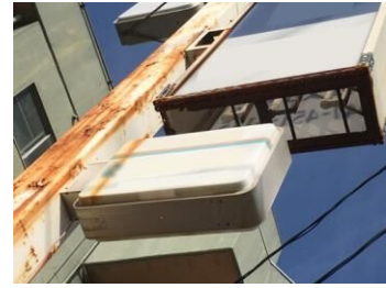
支柱にさびが発生した状態
