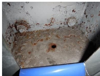
ブラケットの腐食が進行し、劣化した状態
