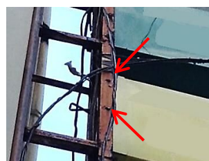
ボルトのゆるみや欠落した状態
