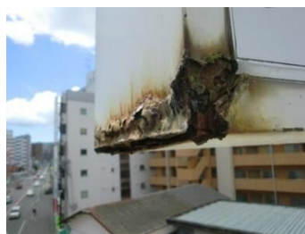
側板の腐食が進行した状態
