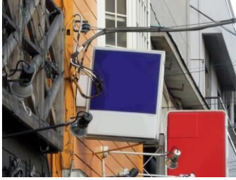
屋外広告物本体の傾き
