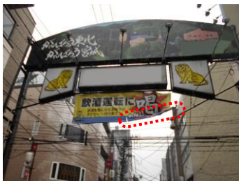
幕材を張る部材が破損した状態
