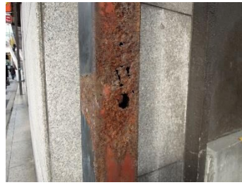
支柱の腐食が進行した状態
