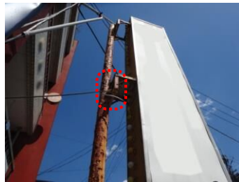
支柱・広告板接合部の腐食・隙間
