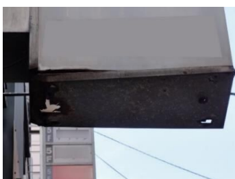
側板底面が腐食、破損、変形した状態
