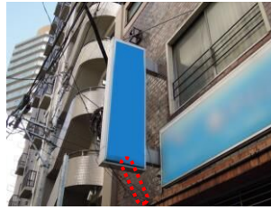
振れ止め棒が変形した状態
