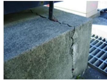
基礎にクラックが入った状態
