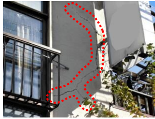
壁面にひびが生じた状態
