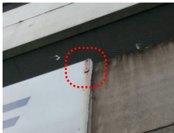
金具が劣化した状態
