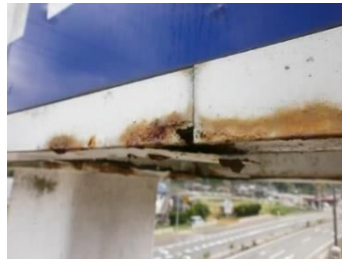
その他（塗装剥離、腐食など）
