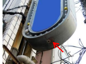
水抜き孔が詰まった状態
