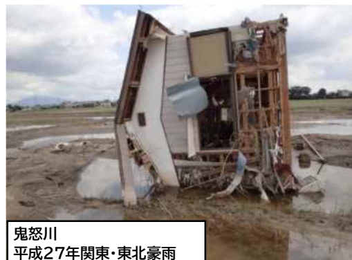
堤防決壊による家屋の倒壊
