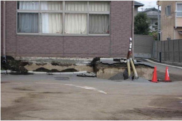
【基礎杭の抜け上がりによる段差の発生】
