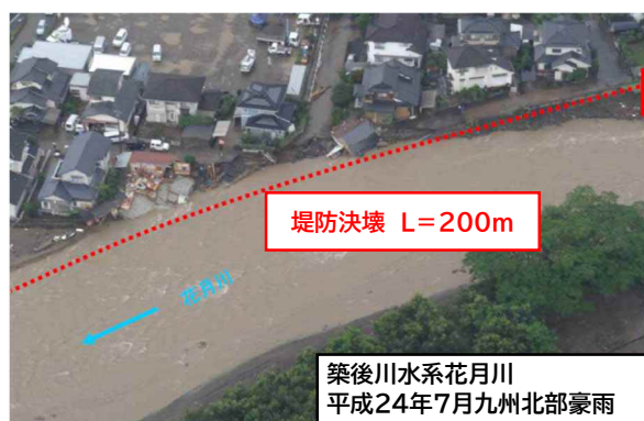
侵食により家屋が流出した状況
