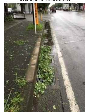
【雨水ますの取水口】
