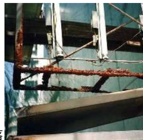
袖看板の底部脱落
