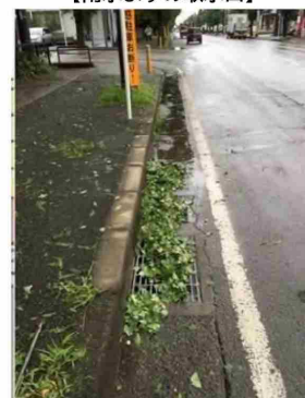
【雨水ますの取水口】
