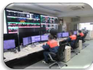
高機能消防指令センター
