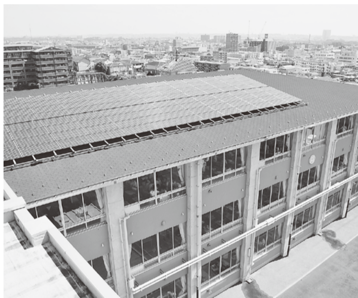
再生可能エネルギーの普及拡大などに向け、公共施設に設置が進められている太陽光発電(写真は南毛利中学校)
