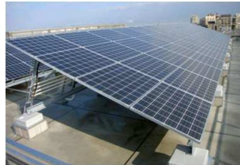
〔太陽光発電設備〕
