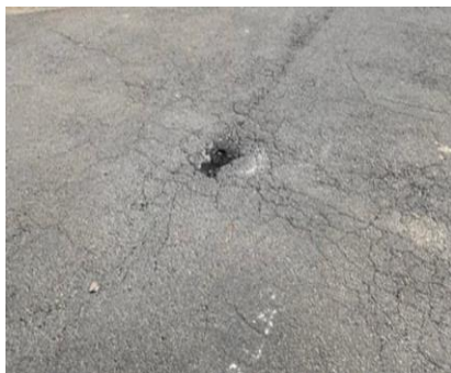
損傷個所の写真 道路(穴ぼこ)
