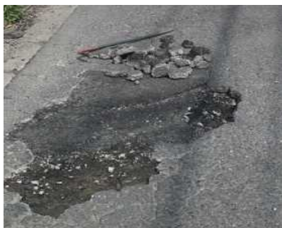
損傷個所の写真 道路(穴ぼこ)
