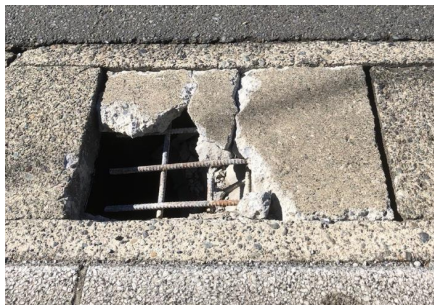
補修個所の写真 道路(側溝の破損)
