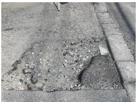
損傷個所の写真 道路(穴ぼこ)
