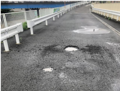
損傷個所の写真 道路(穴ぼこ)
