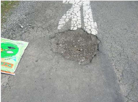
損傷個所の写真 道路(穴ぼこ)
