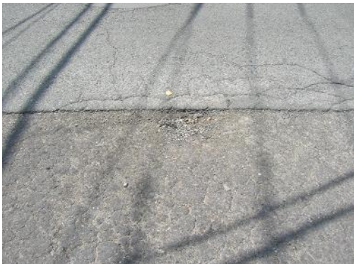
亀裂個所の写真 車道(亀裂及び段差)
