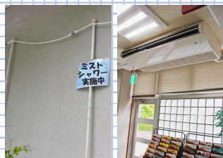
ミストシャワー ロビーの冷房設備
